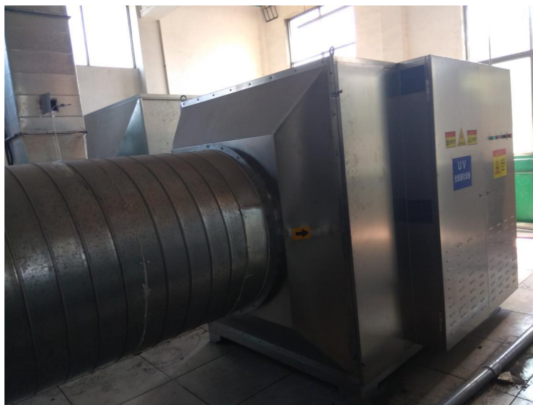
喷漆废气处理设施
