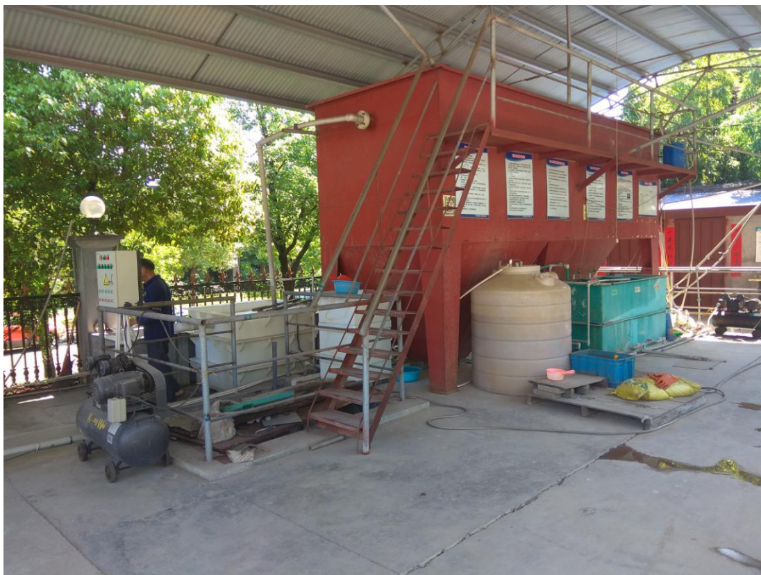
图 4.1-2 生产废水处理设施图
